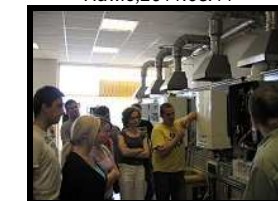
Kotły kondensacyjne Junkers, 2011.05.20
